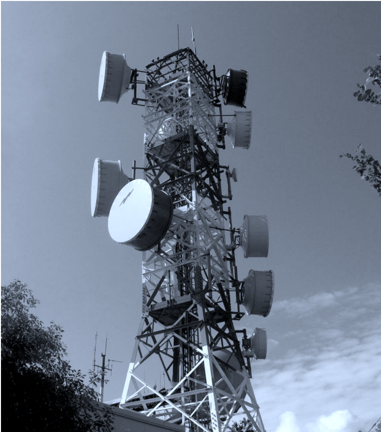
Ιστός ΟΤΕ στη θέση Κουρί
